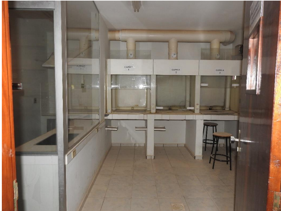
Figura 1 – Vista da entrada do laboratório onde localizam-se as capelas de exaustão de gases com saída de ar para o ambiente externo e no compartimento à esquerda, são feitas as análises de gordura das amostras.
