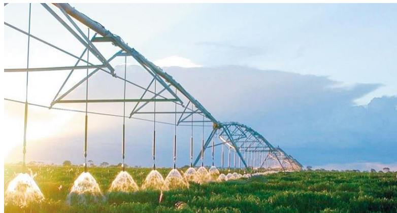
Figura 5 – Estrutura de sustentação e tubulação de distribuição.
