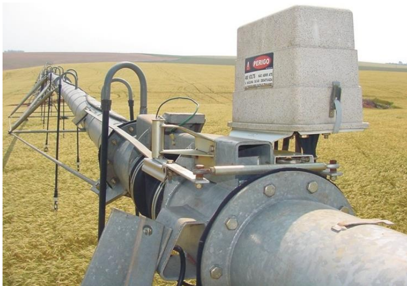
Figura 8 – Caixa de controle de alinhamento.
