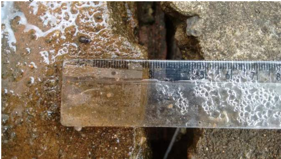
Figura 4.29 – Fissurômetro em 22/02/2019 (2.9cm a 4.9 cm).
