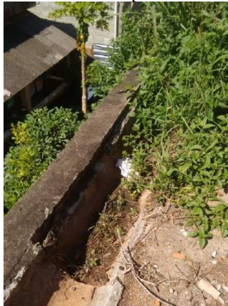
Figura 4.14 – Ausência de limpeza na canaleta de crista.
