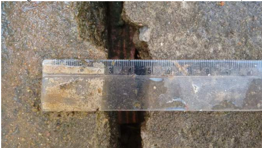
Figura 4.31 – Fissurômetro em 19/03/2019 (2.7cm a 4.9 cm).
