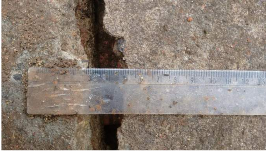
Figura 4.32 – Fissurômetro em 09/05/2019 (2.7cm a 4.9 cm).
