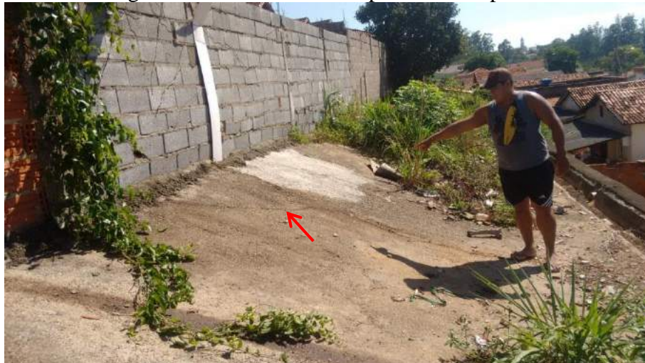
Figura 4.15 – Rachadura no platô do terrapleno.
