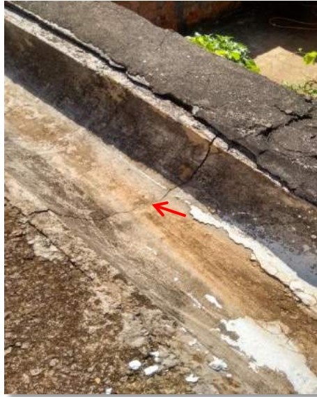
Figura 4.17 – Trinca na canaleta de drenagem.
