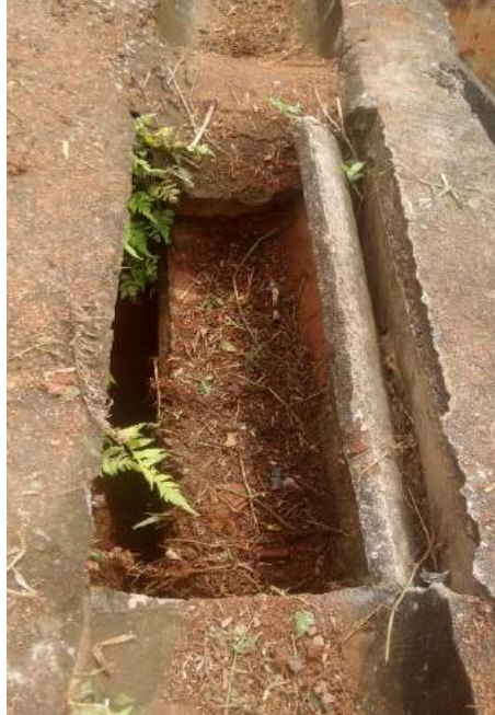
Figura 4.21 – Grota na canaleta de crista.
