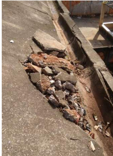
Figura 4.23 – Concreto de impermeabilização do platô fragmentado.
