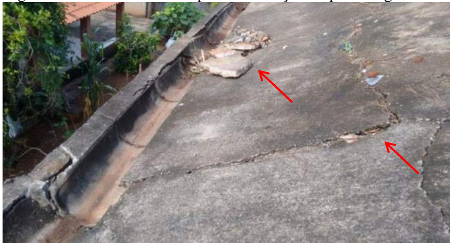
Figura 4.22 – Concreto de impermeabilização do platô fragmentado.
