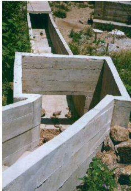
Figura 2.17 – Caixa de passagem.
