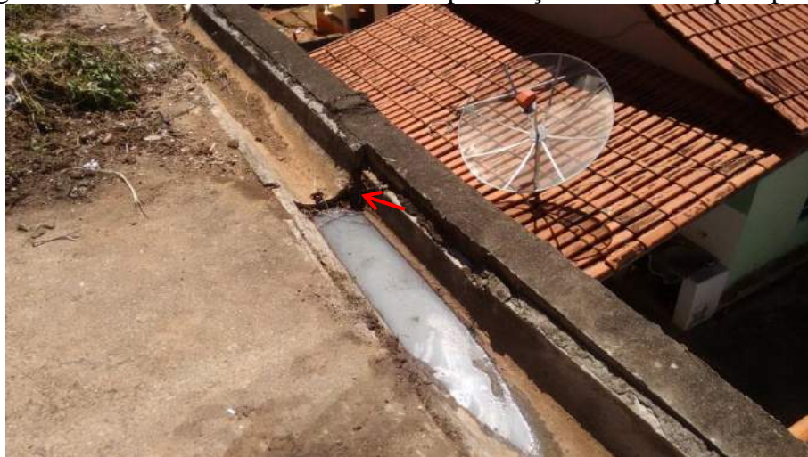
Figura 4.18 – Canaleta recalçou devido à percolação de deflúvio precipitado.
