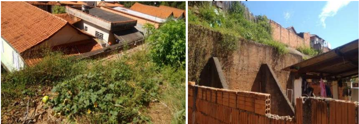
Figura 4.13 – Ausência de limpeza no platô.
