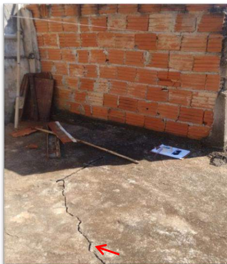
Figura 4.16 – Fenda crítica no platô do terrapleno.
