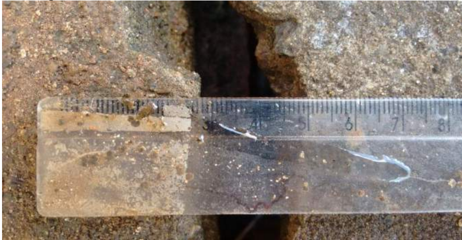
Figura 4.30 – Fissurômetro em 06/03/2019 (2.8cm a 4.9 cm).
