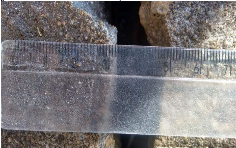
Figura 4.27 – Fissurômetro na instalação em 29/01/2019 (3.2 cm a 4.9 cm).
