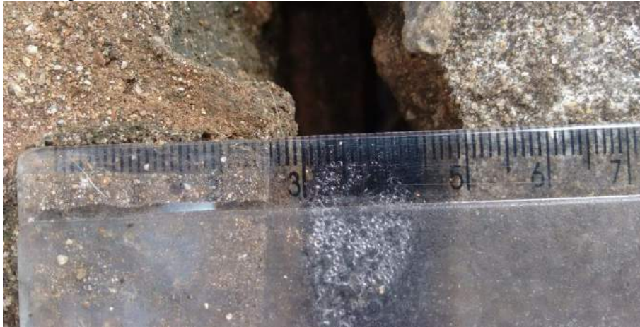
Figura 4.28 – Fissurômetro em 12/02/2019 (3.0cm a 4.9 cm).
