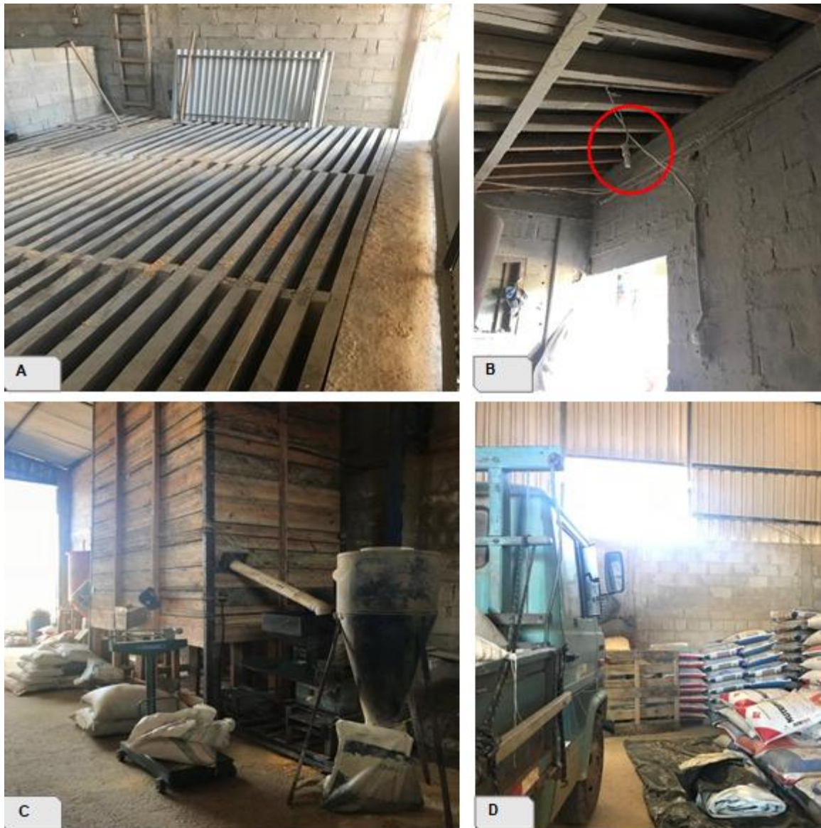
(A) Moega de madeira com milho da última entrega. (B) Lâmpadas sem proteção contra estilhaçamento na sala de preparo de ração. (C) Silo de madeira. (D) Janela sem a existência de proteção contra pragas.
