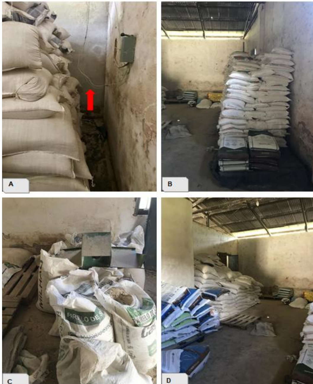
(A) Fiação exposta na sala de armazenamento de matéria prima. (B) Sacarias encostadas na parede. (C) Resíduo orgânico e peças de maquinário em desuso no mesmo galpão de estoque de produto. (D) Parede e chão sem acabamento, com presença de poeira e teto sem vedação, permitindo entrada de pragas. Fonte: Do autor, 2018.
