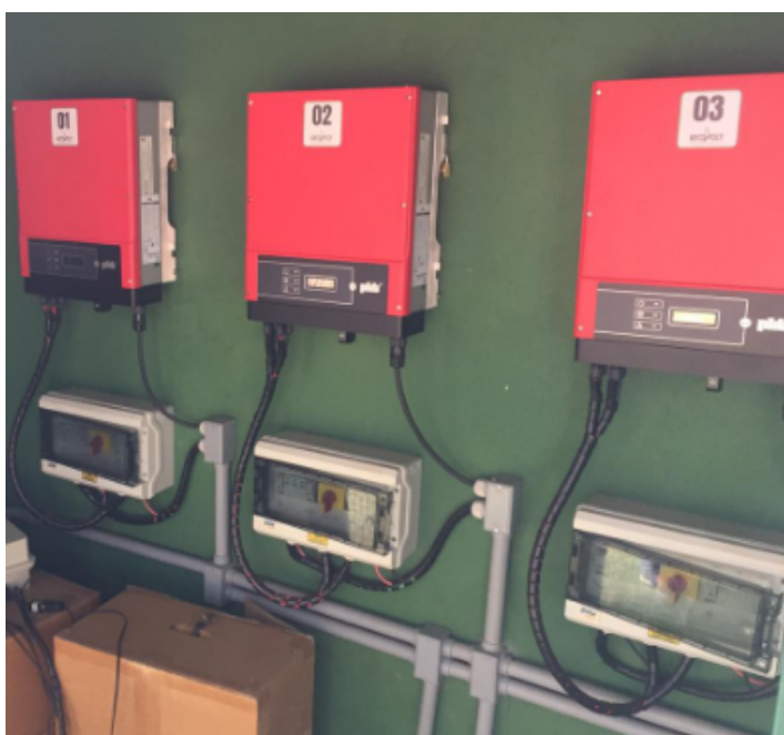
Figura 3.8 – Sistema de Inversores utilizados para placas fotovoltaicas.
