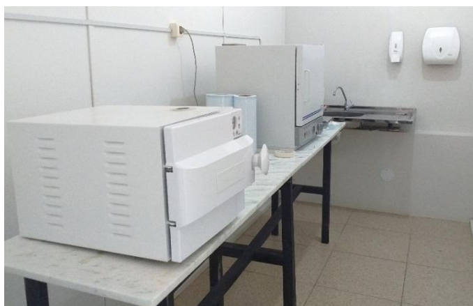
Figura 12 - Vista parcial da Sala de esterilização de materiais da Clínica Veterinária Vet&Pet em Lavras - MG
