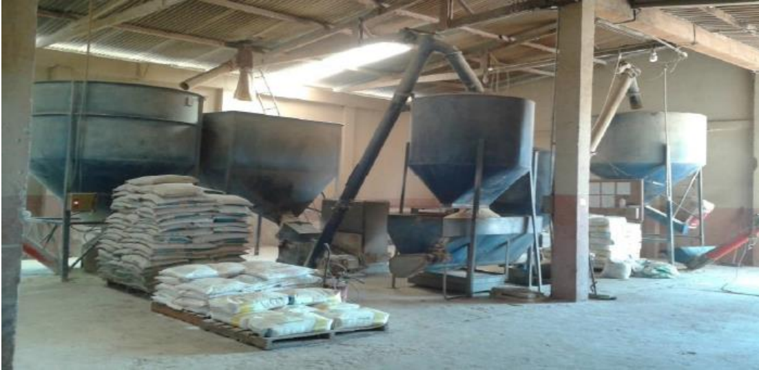
Figura 27 – Fábrica de ração da Fazenda União, Sidrolândia - MS.
