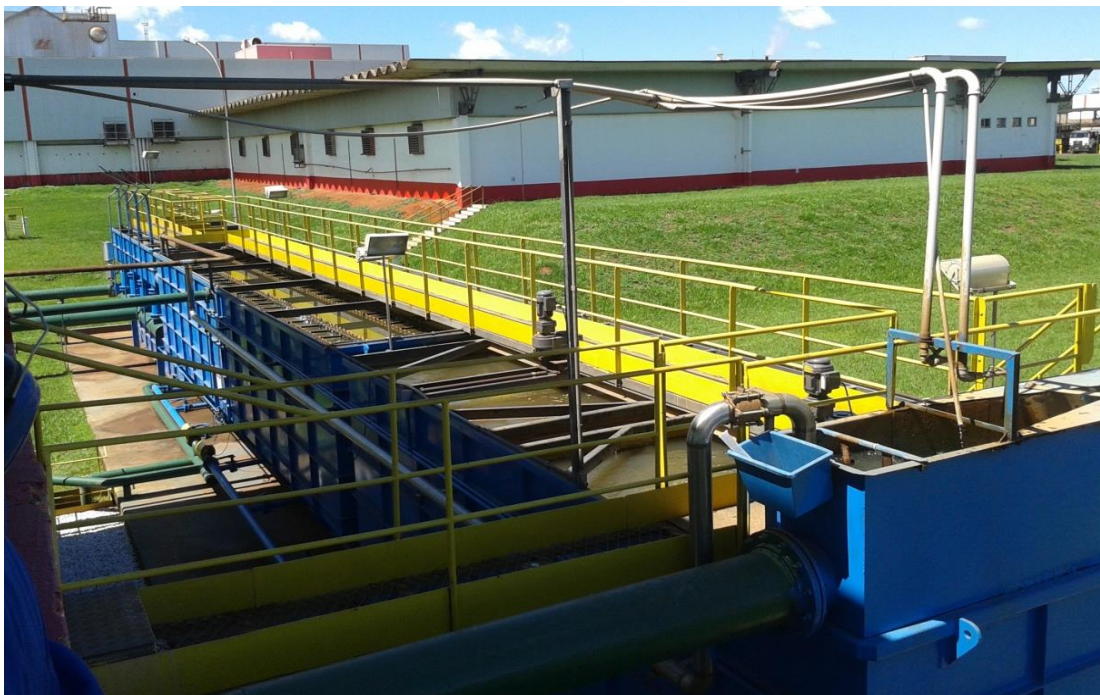
Figura 15- Estação de Tratamento de Água (ETA)
