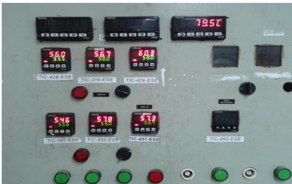
Figura 06- Painel de controle da temperatura dos tanques de escaldagem.
