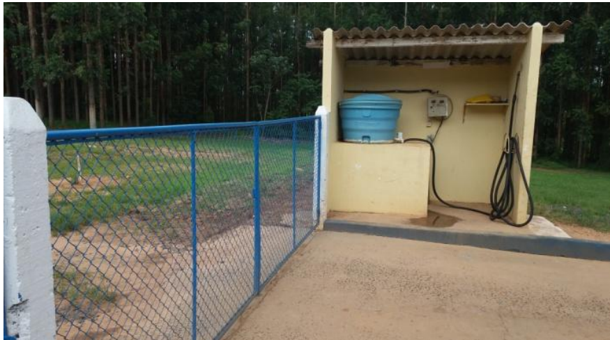
Figura 2. Rampa de desinfecção com mangueira acoplada
