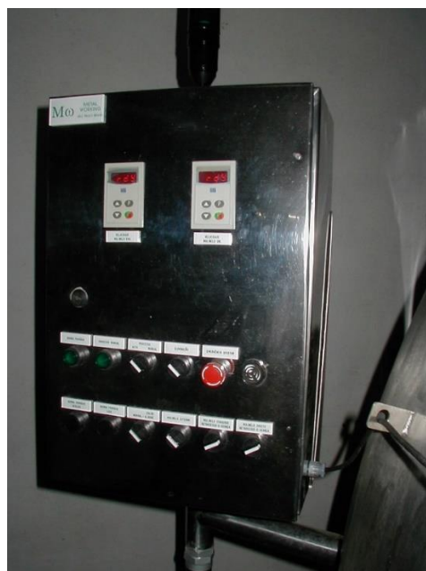
Figura 10 - Painel secundário. Equipamento de tingimento
