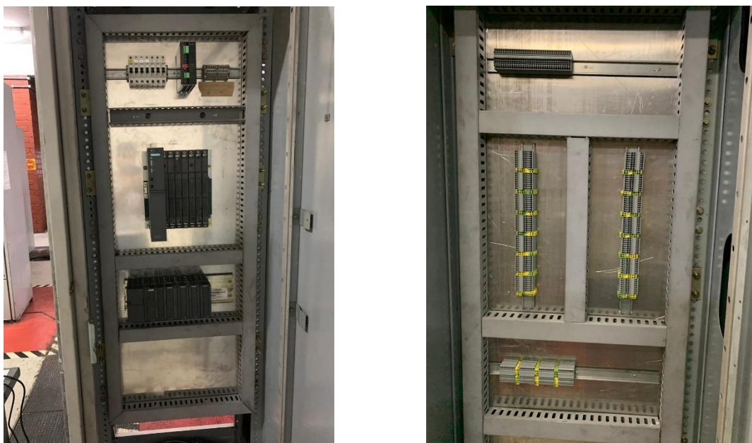
Figura 25 - Painel atual especificado e instalado
